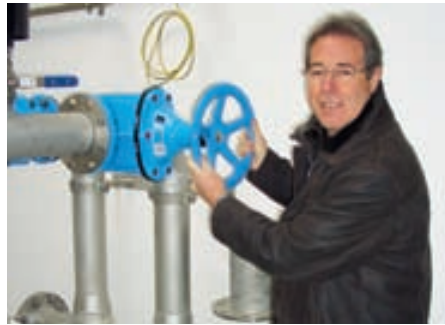
Bürgermeister Helmut Lampert startet die Pumpen im neuen Grundwasserbrunnen Schildried zum Probetrieb.
