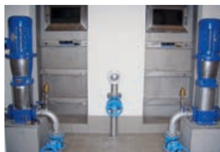
Die zwei Wasserkammern des Hochbehälters Pofel
