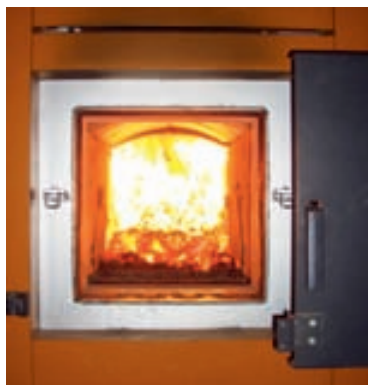
Biomasse Wärmeversorgung Göfis
