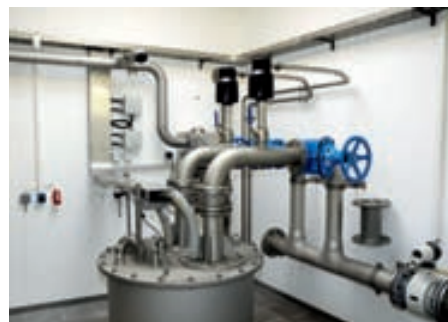
Brunnenkopf mit Transportleitungen im Grundwasserpumpwerk Schildried
