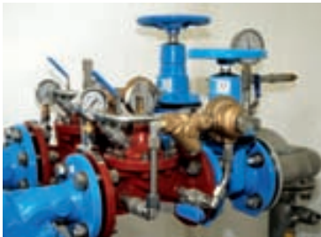
Druckreduzierstation im Grundwasserpumpwerk Schildried
