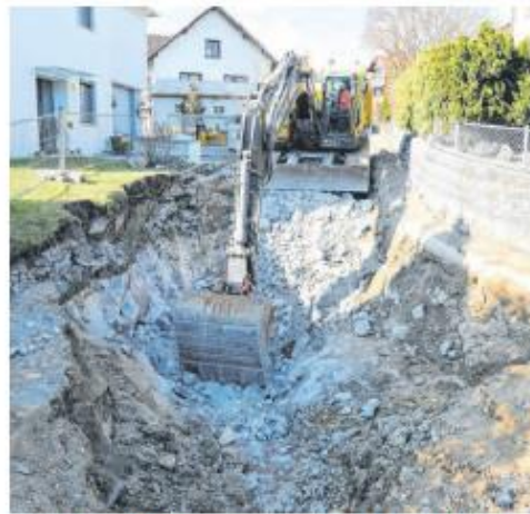
Die Kanalarbeiten in Göfis schreiten zügig voran – aktuell ist die Klosagass betroffen. FOTO: ETU
